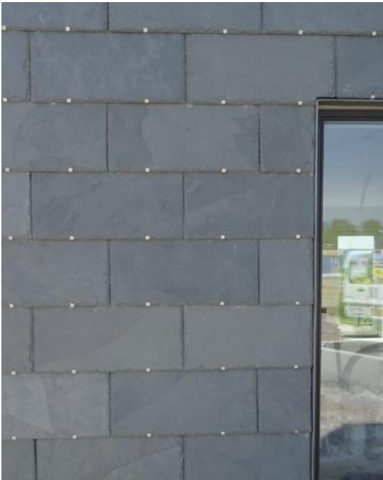
Skiffer monteret med synlige ophængsbeslag
